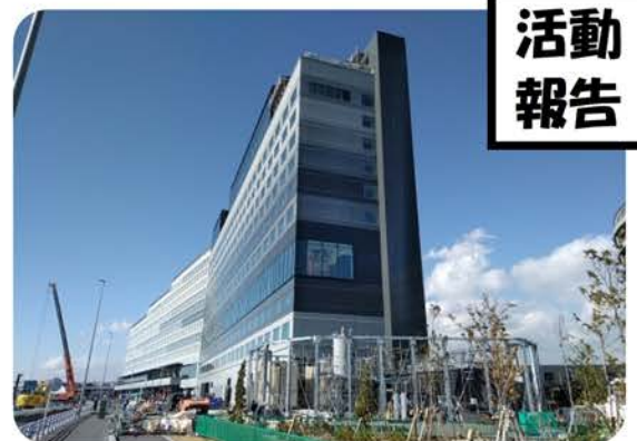
▲羽田空港跡地に建設中の最大の空港ホテルを視察し、羽田新ルートが一部大企業の利益のために進められている現場を見ました。
