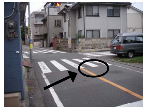
旧出石交番前の交差点の様子。丸印付近が「へこみ」部分です。現在は、応急処置がされています。
