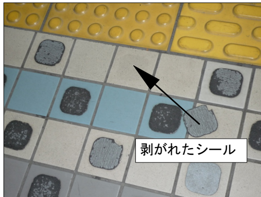
荏原中延駅のタイルに張られたすべり止めのシール
